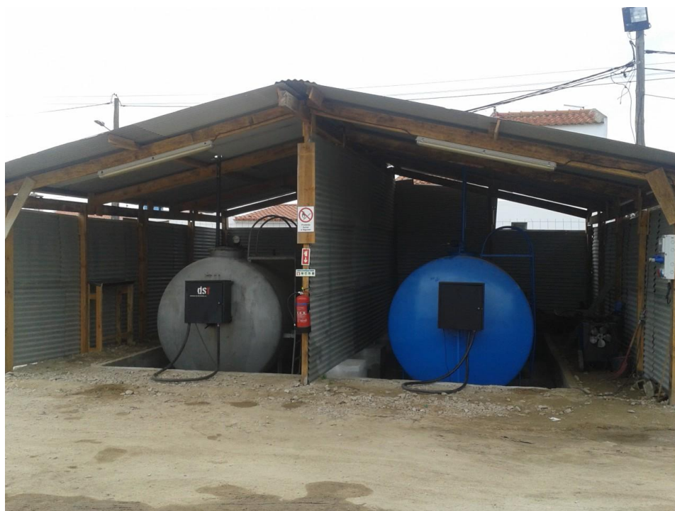
Figura 3 – Zona com bacias de retenção para armazenamento de gasóleo
